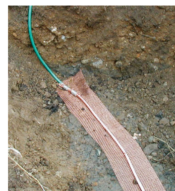
接地銅線はIV線を使用し裸銅線と接続します。
